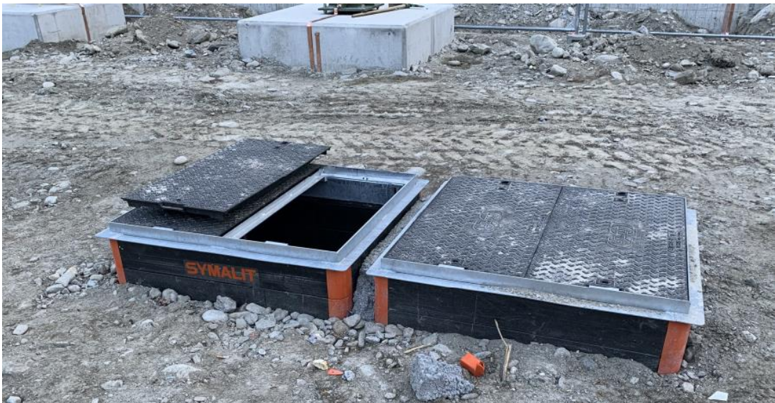
Figure 23: Chambre en plastique ouverte
