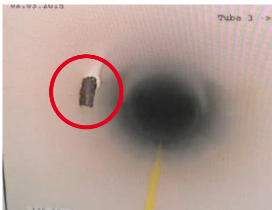
Figure 28: Exemple de dégradation causée par une barre de fer de béton armé ayant transpercé le tube
