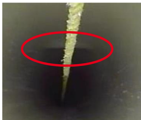
Figure 29: Exemple de dégradation causée par une fissure transversale à l'axe du tube
