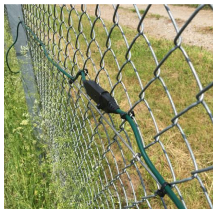
Système de détection sur la clôture
