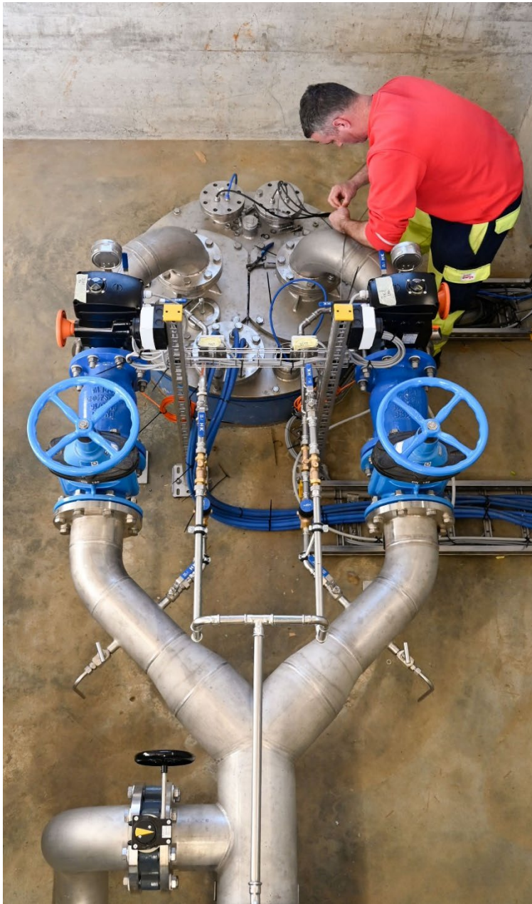
Bildlegende: Das Grundwasserpumpwerk am Ulmenweg hat zwei neue leistungsfähige Pumpen erhalten.
