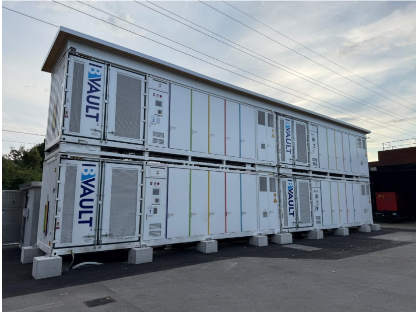
Bild 1: Grossbatteriespeicher bestehend aus vier BVAULT-Containern
