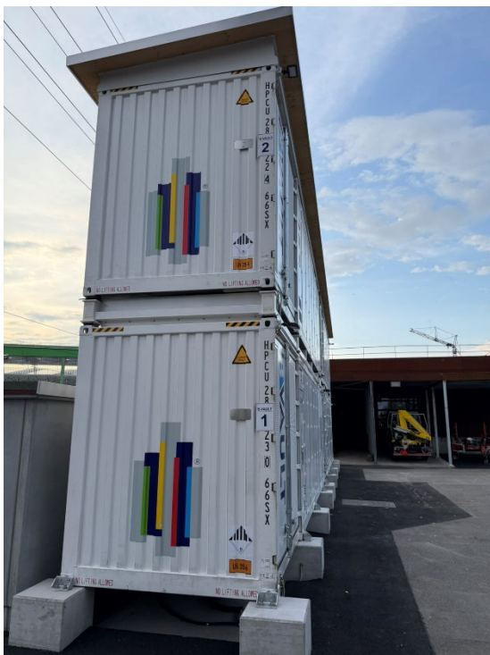
Bild 2: Grossbatteriespeicher bestehend aus vier BVAULT-Containern
